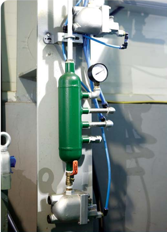
▲ 배관라인에 설치된 예
