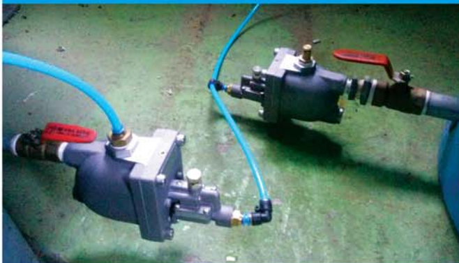
▲ 두 대의 리시버탱크에 동압관을 설치한 경우 (사정이 여의치 않을시 에어벤트를 부착)
